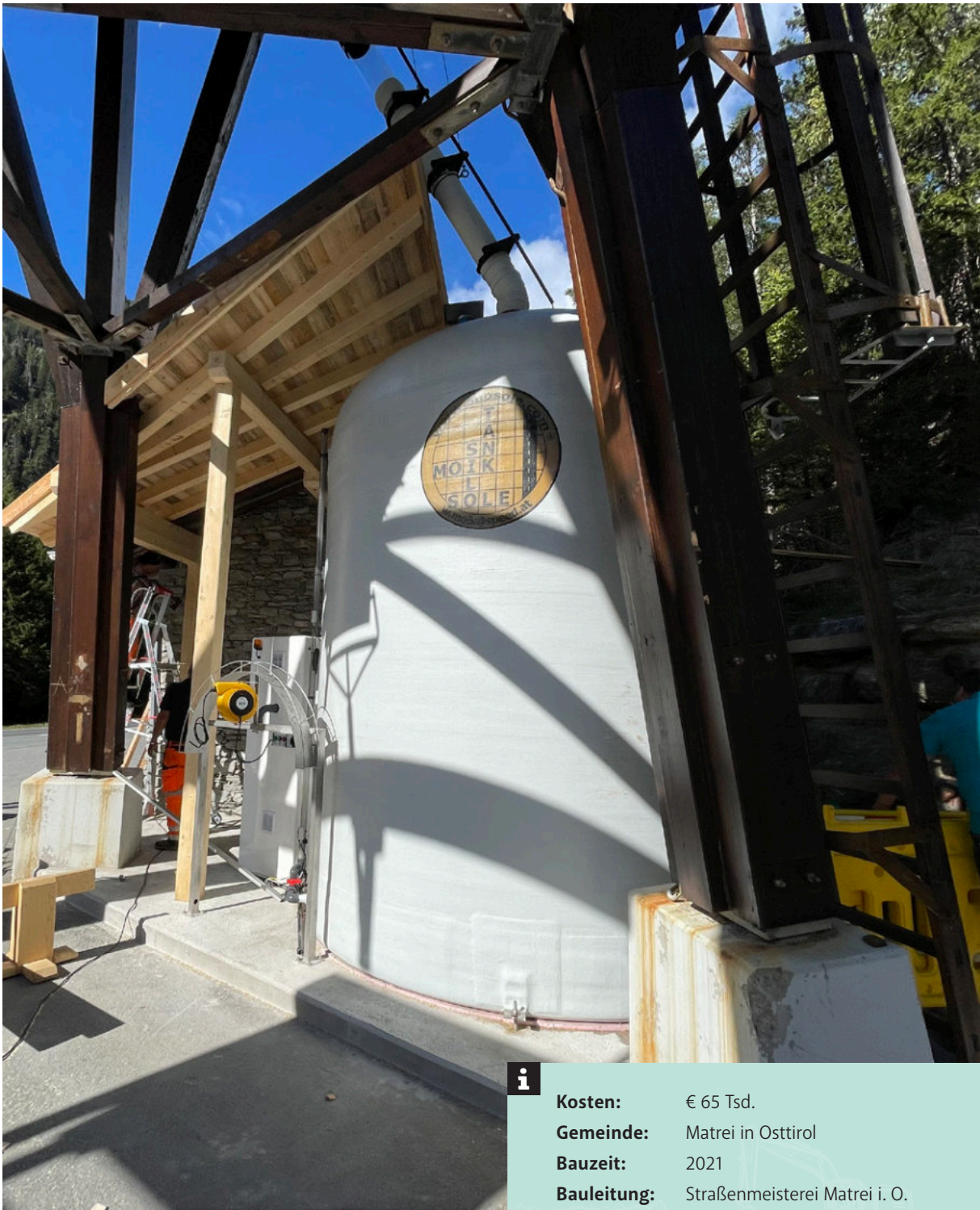
Soleanlage unter dem bestehenden Streugutsilo situiert und angeschlossen
