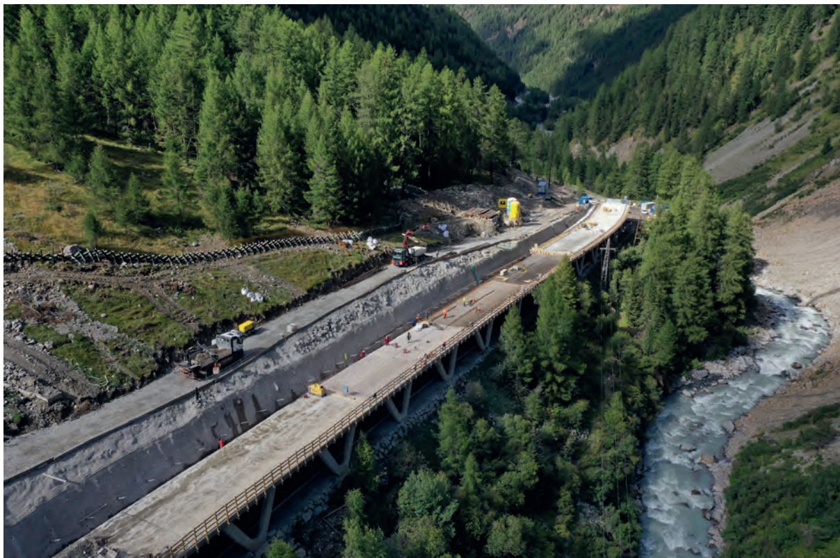
Schutzwand für die Sicherheit der Arbeitnehmer
