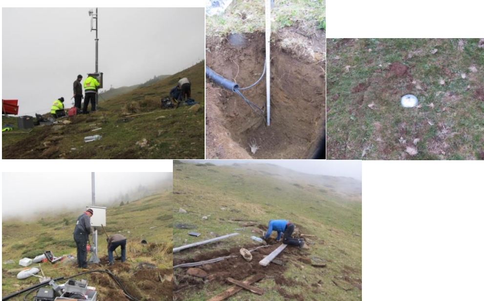
Bildinhalte: Erneuerung des Datensamplers inkl. Solarstromversorgung und Einbau mit Vermarkung der Messsensoren Fotos Land Tirol, Hydrographischer Dienst
