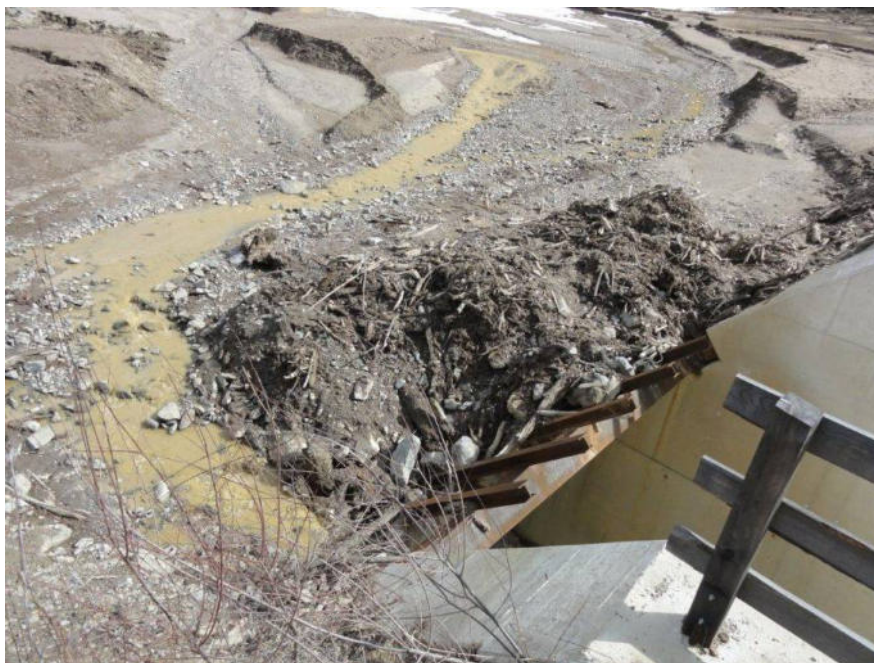
Abbildung 4: Murholz im Geschieberückhaltebecken, Bereich Rechen
