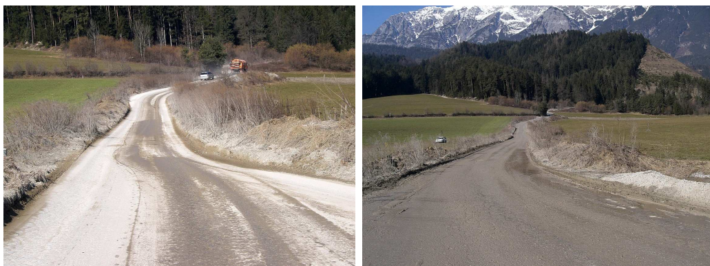
Abbildung 3.48: Hohe Staubbelastung der Dämme links und rechts neben der Fahrbahn.
