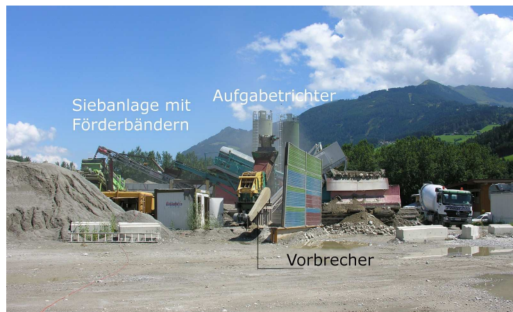
Abbildung 3.3: Aufbereitungs- und Betonmischanlage I in Weer
