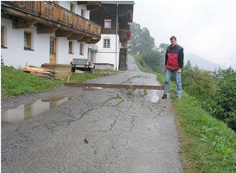
Sanierungsbedürftige „Wegabsitzung“ im Bauabschnitt II
