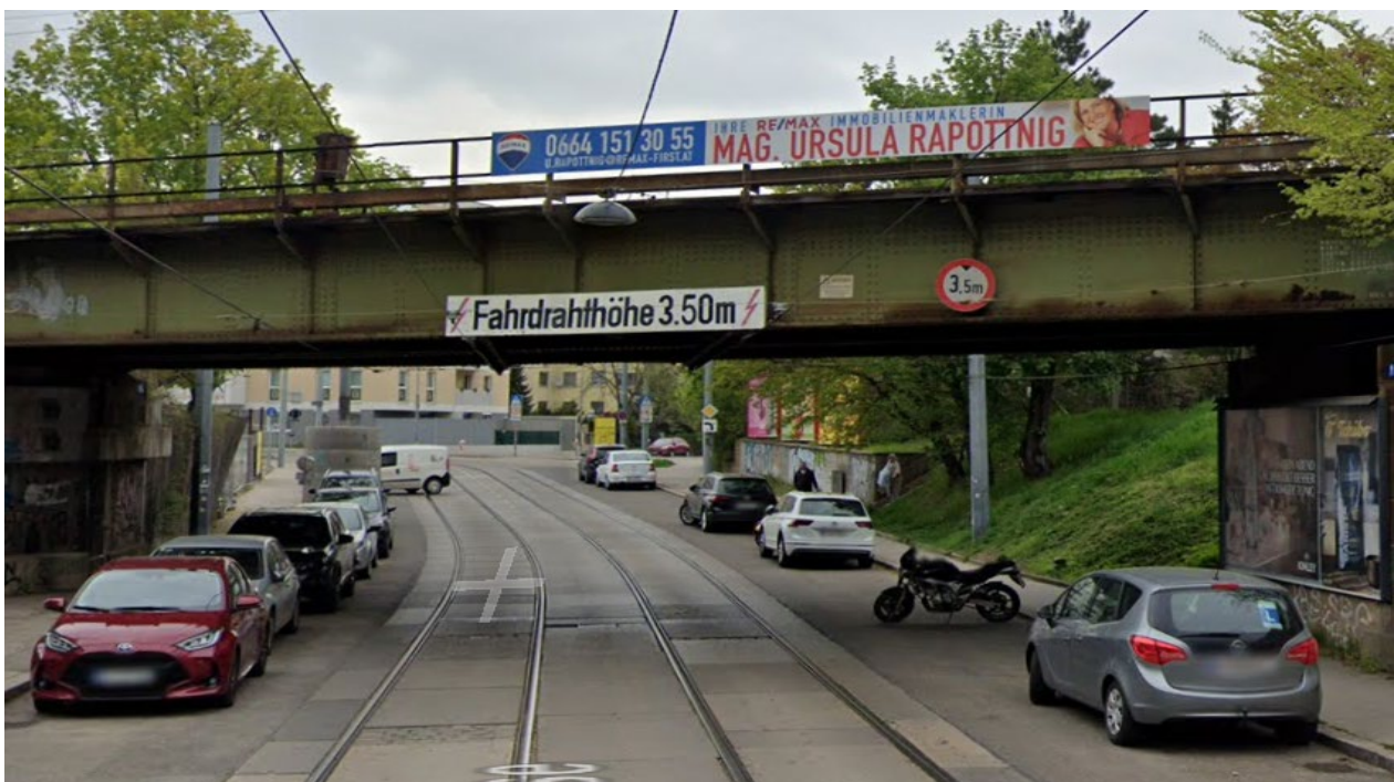
Abbildung 14: Minimale Fahrdrathöhe von 3,72m über SOK bei 600V DC bei den Wiener Linien, Linie 60, Hofwiesengasse © google street view (04/2022)
