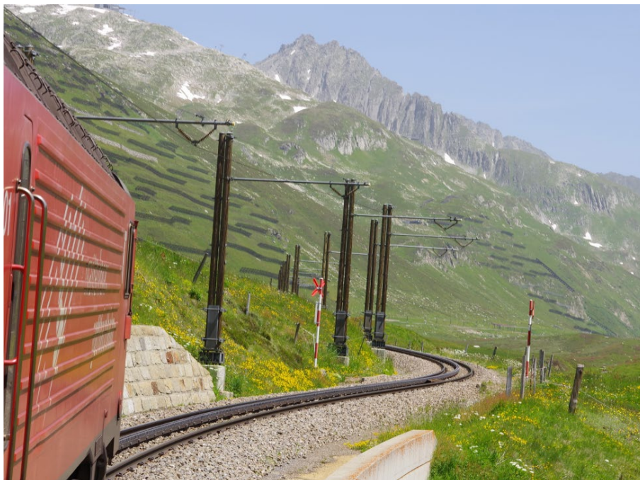
Abbildung 65: Doppelholzmasten von Furrer & Frey in lawinengefährdeten Abschnitten am Oberalppass der Matterhorn-Gotthard-Bahn MGB, 11 kV 16,7Hz, © MfV 3703
