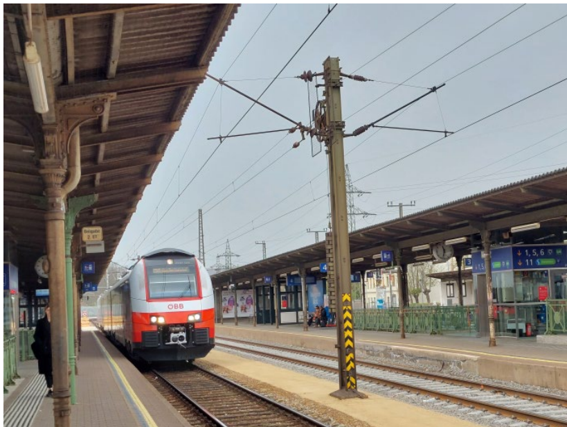
Abbildung 5: Oberleitungsmast mit Abspannvorrichtung aus 1952, Bhf. Wien Hütteldorf – links: Originalisolatoren, rechts: ausgetauschte Isolatoren und Ausleger © 2024: MfV 20240331_113328
