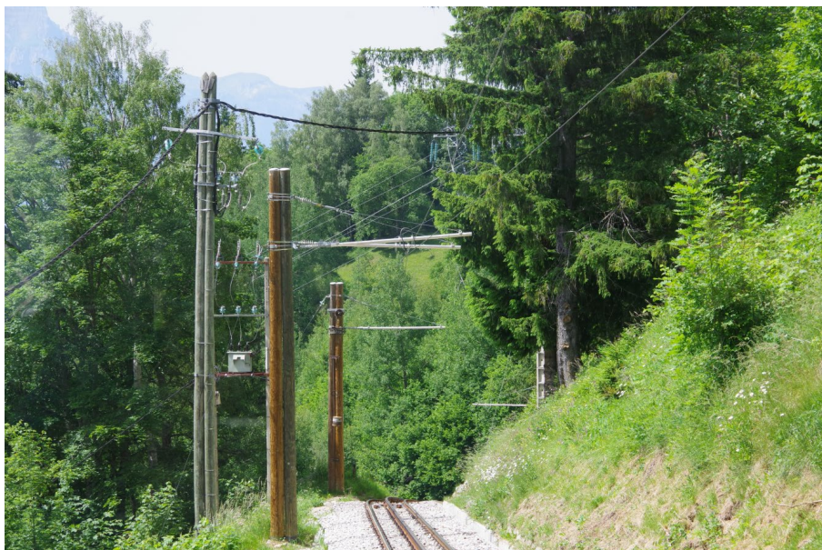
Abbildung 63: Einspeisung und Abschnittstrennung mit Holzmasten bei der TMB, © MfV 3039
