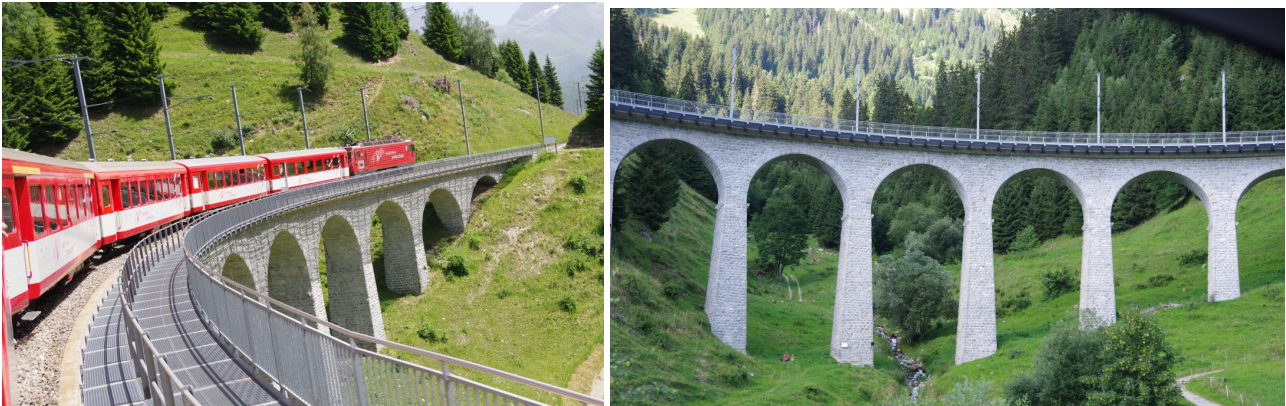
Abbildung 66: Negativbeispiel extrem kleiner Mastabstände von unter 15 m im 100 m Bogen des Bugnei-Viadukt der MGB zwischen Sedrun und Distentis/Muster, Graubünden, Schweiz © MfV 3784, MfV 8571
