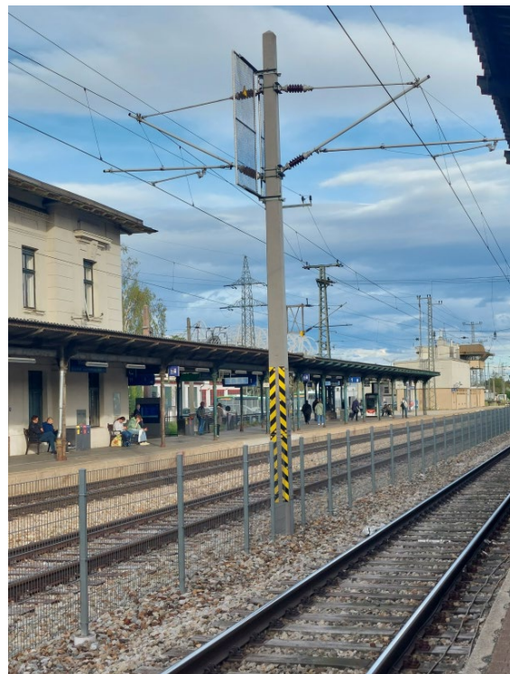
Abbildung 7: Oberleitungsmittelmaste Bauarten Maba Bhf. Wien Hütteldorf: Hauptgleise (Bst. 2 und 3) mit getauschtem Mast und Ausleger im Mischbetrieb mit der Originaloberleitung © 2024: MfV20240404_174304
