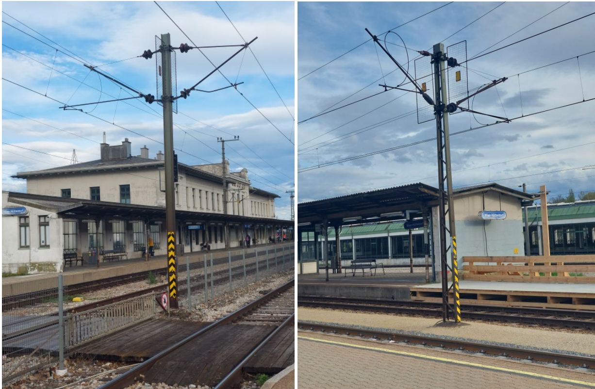
Abbildung 6: Oberleitungsmittelmaste zweierlei Bauarten aus 1952, Bhf. Wien Hütteldorf – links: I-Trägermast beide Hauptgleise (Bst. 2 und 3) mit Originalisolatoren und Ausleger, rechts Gittermast mit modernisierten und originalen Isolatoren/Ausleger (Bst. 4 und 5) © 2024: MfV 20240404_174006, 20240404_174029
